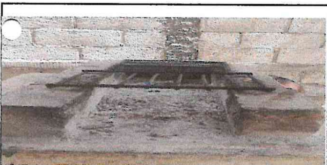
Foto 11: Sustitución de plancha por una de 3 hornillas
